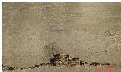
Slika 3-31: Oštećenje na donjoj komori
