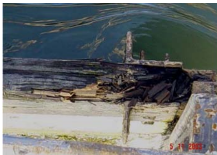
Slika 3-12: Oštećenje na ploči ustave
