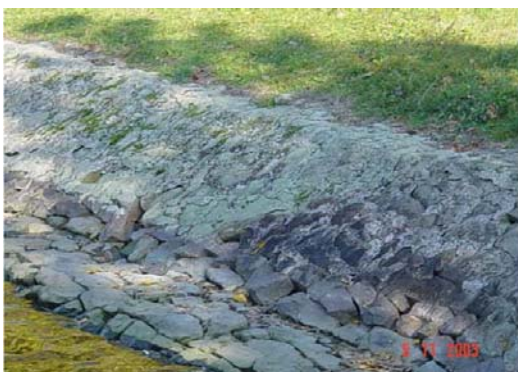
Slika 3-24: Oštećenje na zaštitnoj kosini uzvodno
