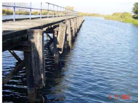
Slika 3-17: Oštećeni drveni stubovi
