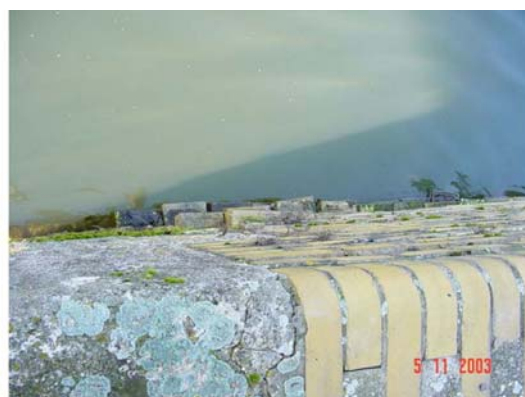
Slika 3-21: Oštećenja zidanih delova
