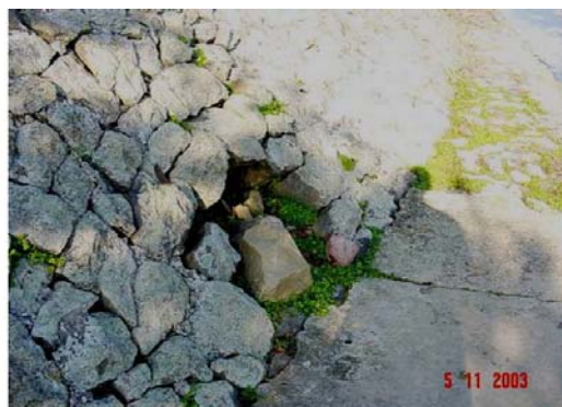
Slika 3-25: Oštećenje na zaštitnoj kosini nizvodno
