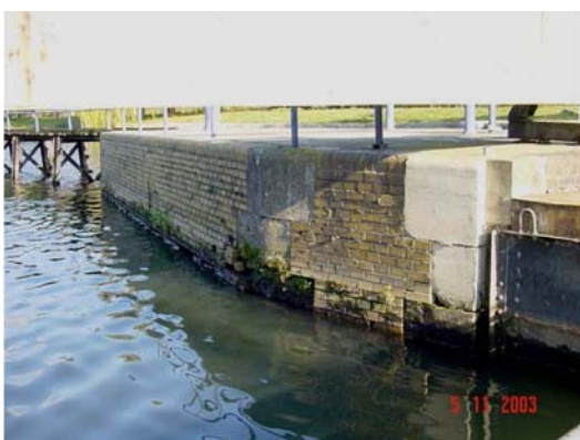
Slika 3-20: Oštećenje ozida na razdelnom zidu između prevodnice i Kanala, uzvodno
