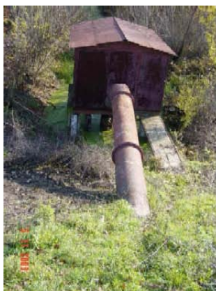
Slika 2-6: Pumpna stanica za odvodnjavanje
