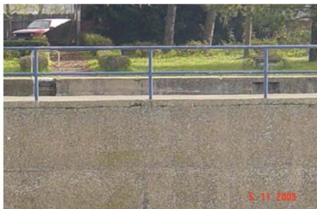
Slika 3-38: Pukotina u betonskom pokrivaču
