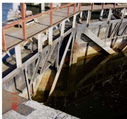
Slika 3-19: Korozija na gornjim vratima
