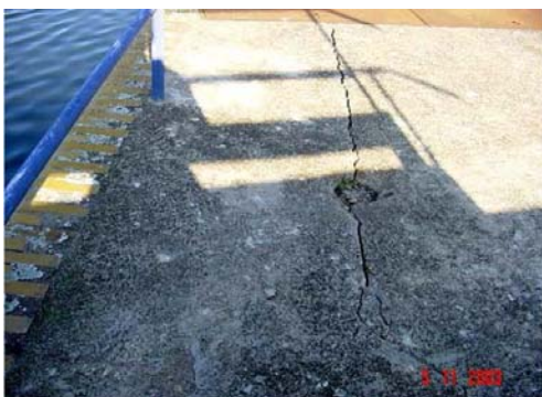
Slika 3-22: Pukotina u betonskoj ploči
