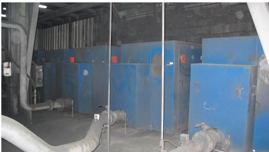
Slika 12. Postrojenje Mlina uglja (duvaljke)
