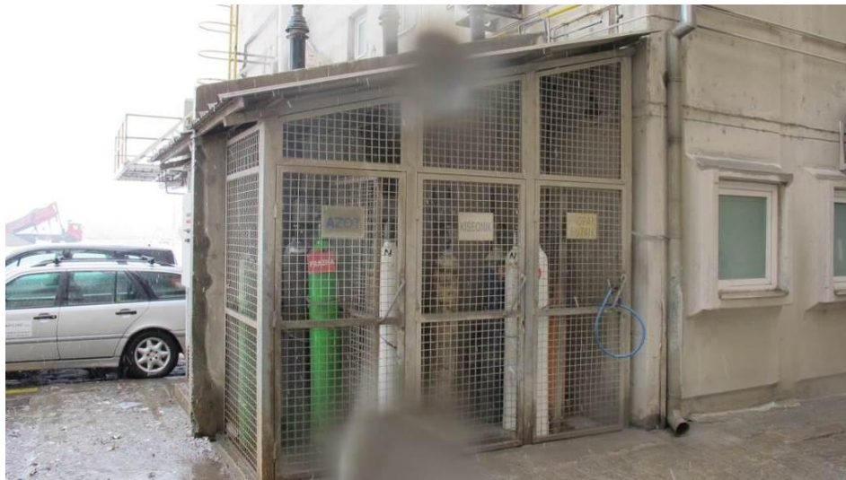
Slika 13. Skladište boca pod pritiskom
