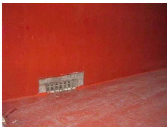
Slika 10. Rešetka za prihvrat prolivenih tečnosti u slučaju akcidenta
