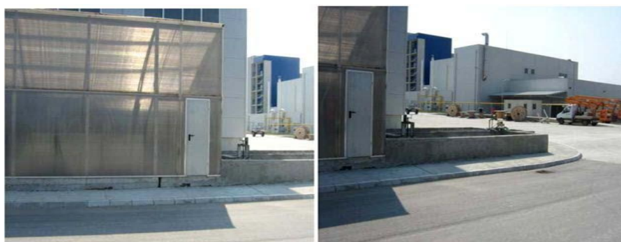
Slika 11. Postrojenje za prečišćavanje otpadnih voda
