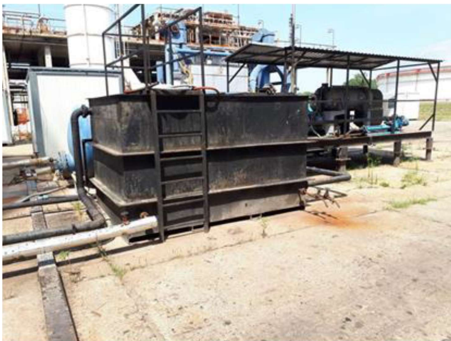
Slika 13. RO-RO blok sa mešalicom
