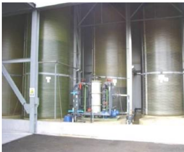
Слика 12- Постројење за складиштење киселине
