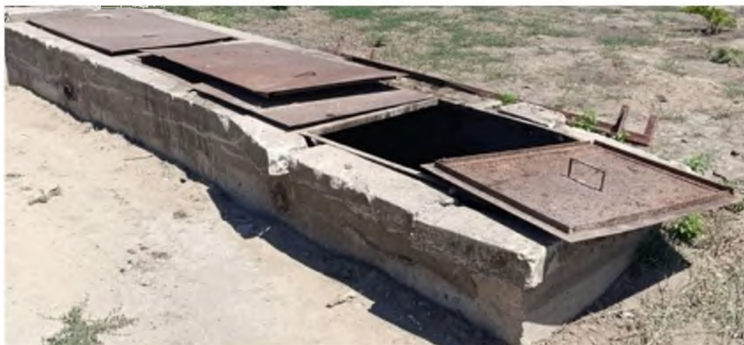
Slika 14: Naknadno uočeni postojeći separator masti i ulja, koji pripada tipskoj liniji GSH
