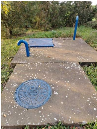
Слика бр. 8: Бунар са бунарском опремом и филтерском конструкцијом
