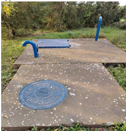
Слика бр. 9: Бунар са бунарском опремом и филтерском конструкцијом
