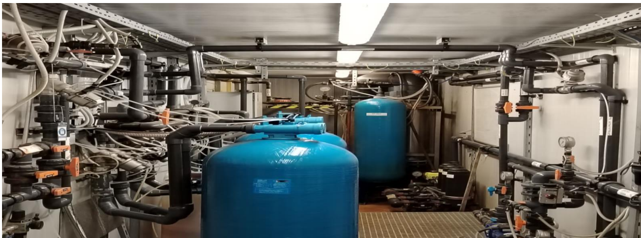
Слика бр. 3: Постројење за пречишћавање вода ППОВ
